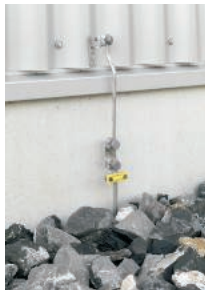
Ревизионен участък на заземителна инсталация
