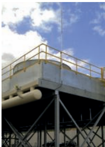
Изолирана отводителна система във взривоопасен участък
